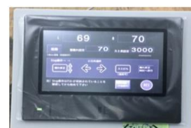
写真-4 操作パネル
