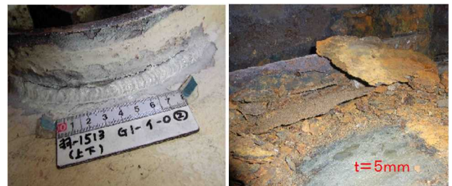
(a) 切り欠き部のき裂 (b) 下フランジの腐食 写真-2 外桁の損傷状況
