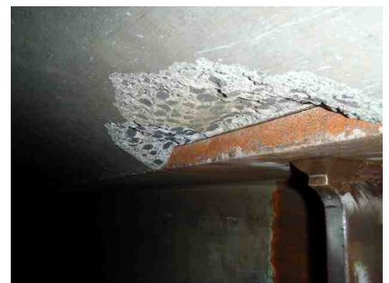
写真-1 コンクリート片剥落状況
