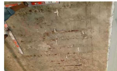
写真1 床版のひび割れ状況
