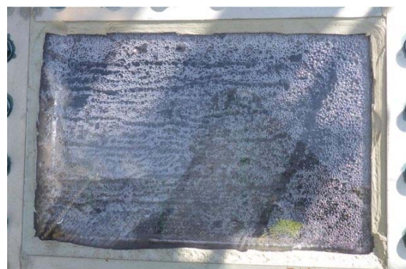
写真-2 主ケーブル内部結露状況
