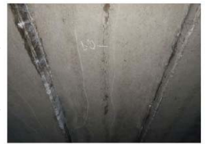
写真1 PC 桁のひび割れ
