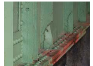
写真2 垂直補剛材の破断
