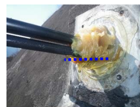
写真-5 防錆油変色
