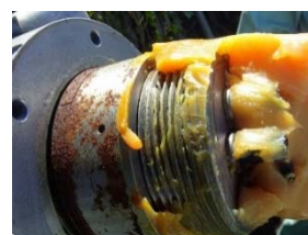
写真-3 アンカーヘッドの腐食
