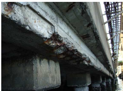
図-2 東品川棧橋損傷状況
