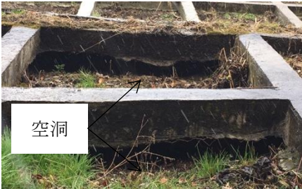
図-1 吹付格子砕工の背面空洞
