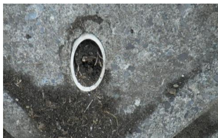
図-2 排水パイプの目詰まり
