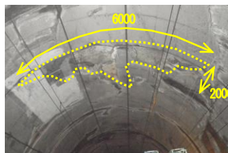
写真-1 剥落状況
