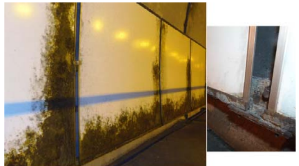
写真-1 内装板と取付け金具の劣化
