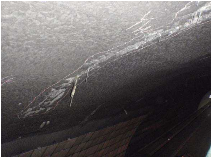
写真-1 エフロレッセンス状況
