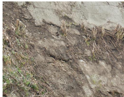
図3 張コンクリートの変状箇所の一例
