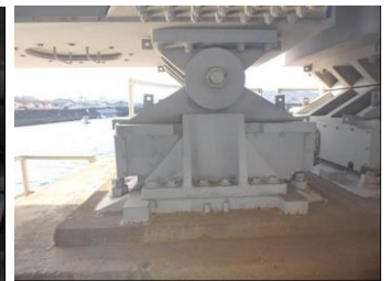
写真-4 油槽付き支承 側面
