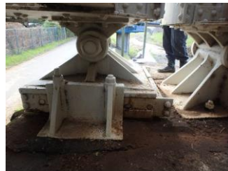
写真-2 当該支承
