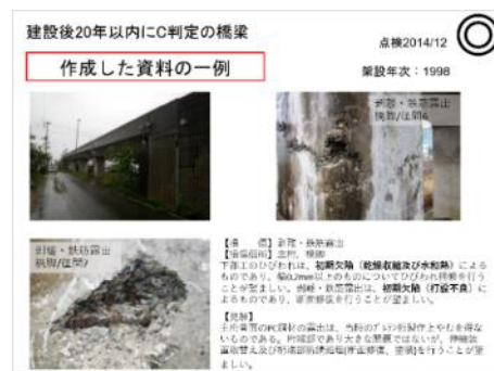
図-2 対策区分 C 判定の◎の橋梁の例
