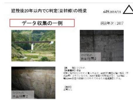
図-3 対策区分 C 判定の△の橋梁の例
