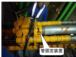
写真-4 管固定装置
