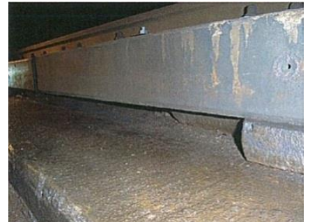
写真－1 寒冷地における CA モルタル損傷の状況
