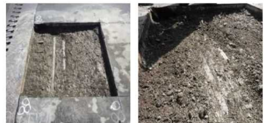
写真-1 微破壊試験状況(砂利化)
