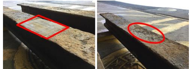
図-7 連接軌道(左)とプラバン(右)の腐食傾向
