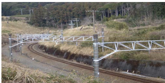
図-1 金谷菊川駅間軟弱路盤箇所
