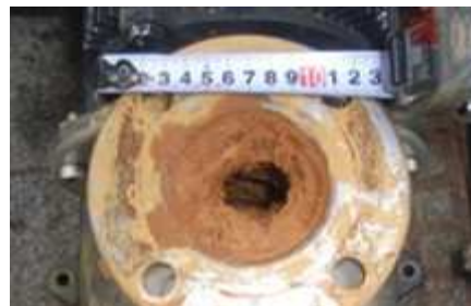
写真-1 ポンプ内スケール付着状況
