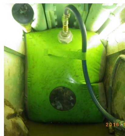
写真-5 管内の状況
