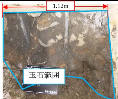
写真-1 刃口内玉石状況
