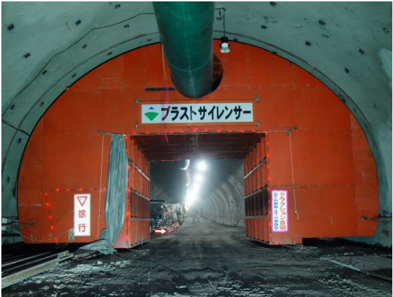
写真-2 トンネル発破低周波音消音器
