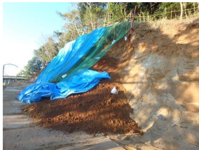
写真-1 地山表層の崩壊状況
