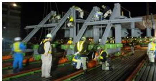
写真-1 方杖耐震設備
