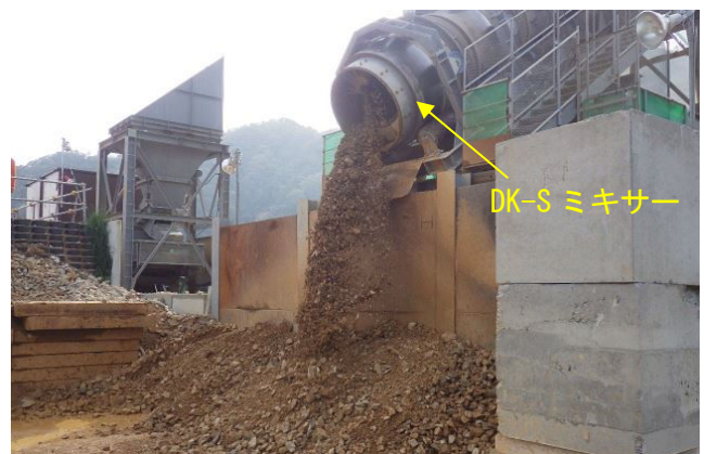
写真-2 DK-S ミキサー出口のブレンド状況
