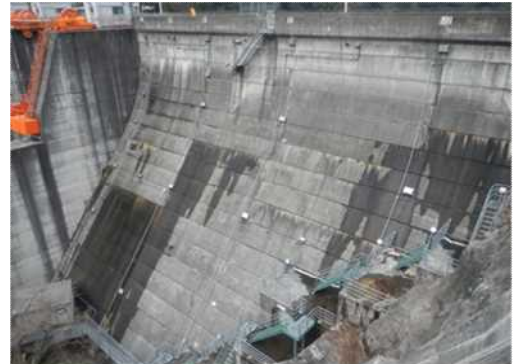
写真-1 堤体下流面漏水の事例 (A ダム)
