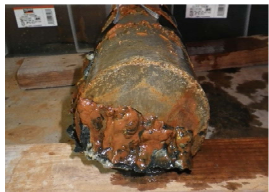
図—4 ひび割れからの腐食生成物の流出
