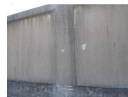
写真-3 調査箇所 (変状小)
