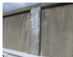
写真-2 調査箇所 (変状大)
