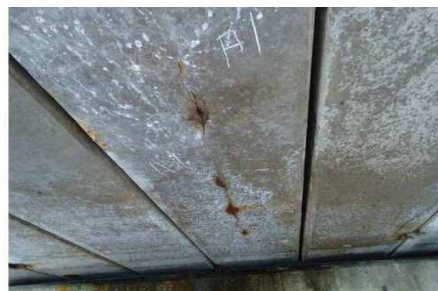
写真-1 PC 構造物の劣化 (外観)
