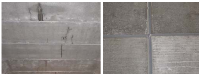
写真-1 ひび割れや段差・目地のズレの状況
