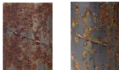
図4 経過日数7日の腐食の様子
