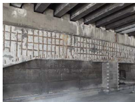
図-1 再劣化により損傷した橋脚
