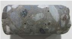
写真-2 大正供試体 No. 1 60 サイクル時の損傷状況
