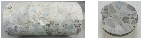
写真-1 大正時代後期コンクリートコアの外観
