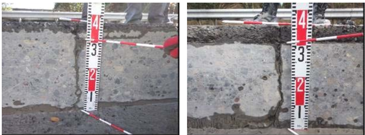
写真-2 コンクリート版と路盤界面の状況（左：健全部、右非健全部）
