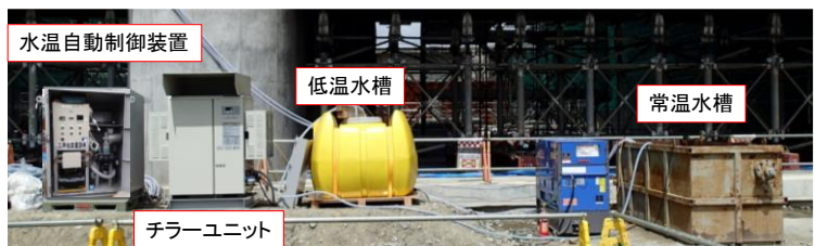
写真-1 現場での設置状況
