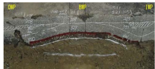
写真-2 変状箇所開削断面 (KP121.565)
