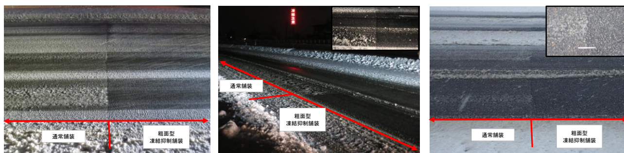
写真－1 凍結抑制舗装（粗面型）の効果を確認した状況例（左から供用1冬目、2冬目、4冬目）
