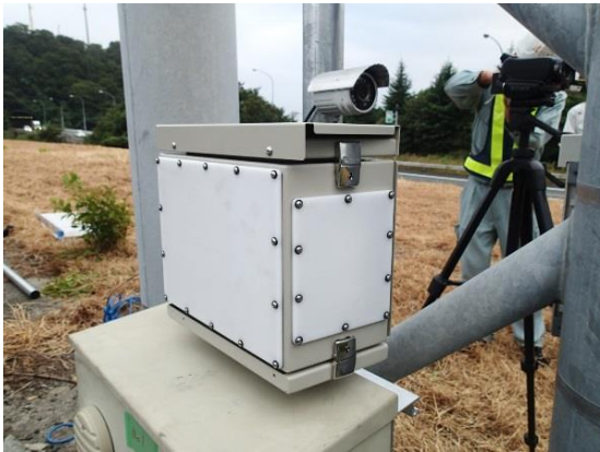
図-2 本機器設置写真
