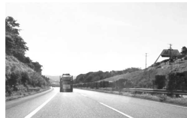
写真2 樹木が欠損した中央分離帯
