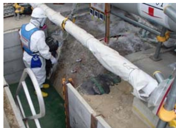
写真-3 凍土露出部
