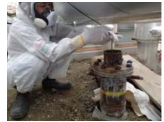
写真-1 光ファイバ式温度計の設置状況
