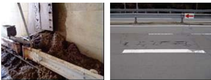
写真-1 C-Box 継目部の土砂噴出(左), 路面亀甲クラック(右)
