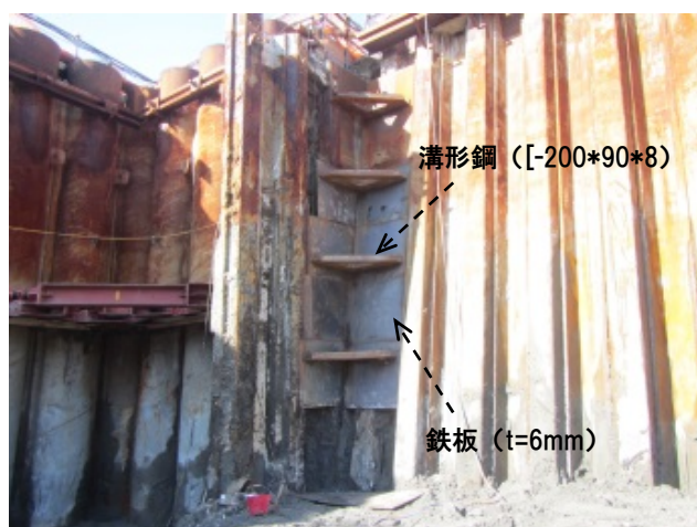
写真-2 鋼矢板未接合箇所
