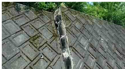
写真-5 鉛直目地のずれ
