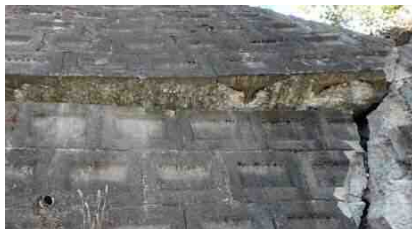
写真-2 目地部のずれ(折損)
