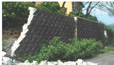
写真-4 前傾と一部崩壊
