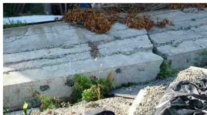
写真-1 擁壁の倒壊
