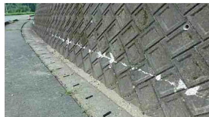
写真-6 直線状のひび割れ
