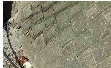
写真-3 鋸状のひび割れ
