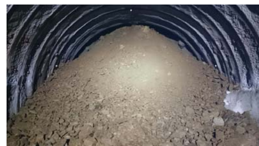
写真-1 切羽崩落状況
