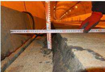
写真 1 路面隆起状況
