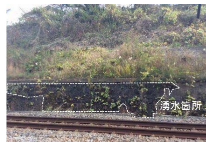
写真3 左側石積壁湧水状況
