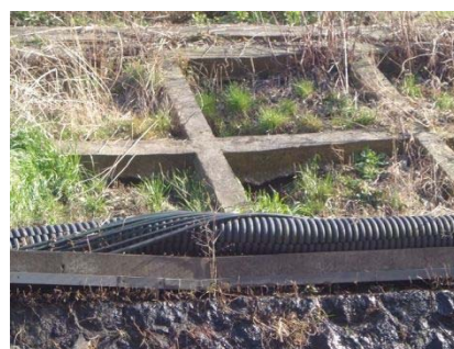
写真2 左側のり面表層流出状況
