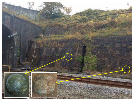
写真4 レンガ積壁湧水及び背面地山状況
