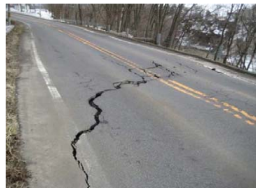
写真1 対象現場の路面変状
