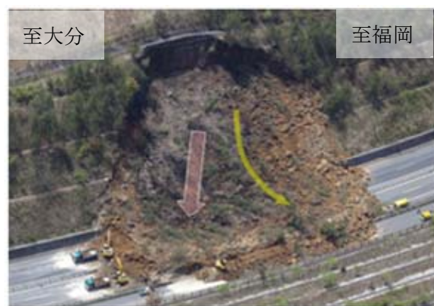
図-2 土砂崩落状況
